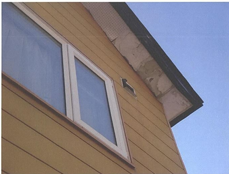
軒天の損傷状況
